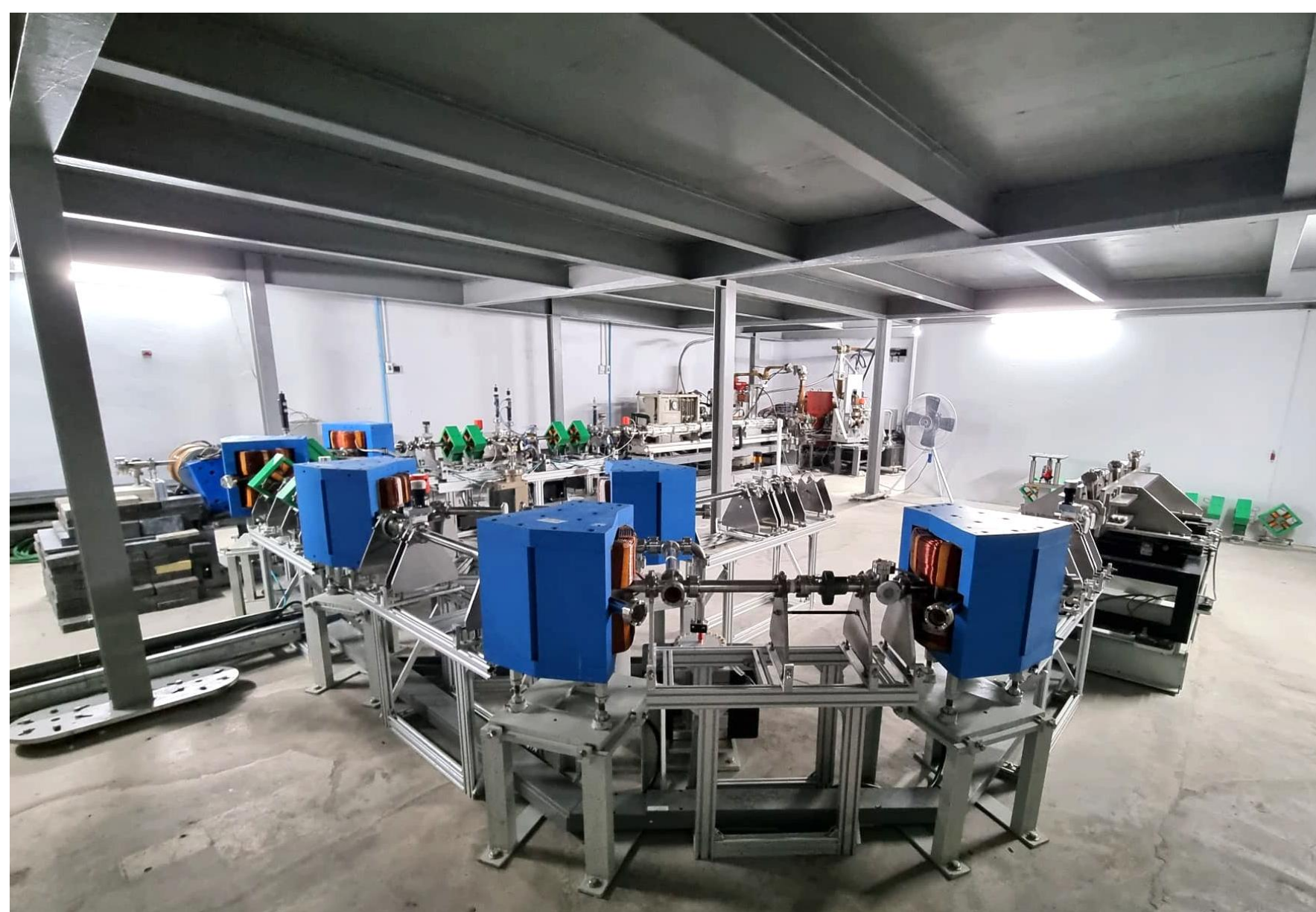
เครื่องเร่งอนุภาคอิเล็กตรอนและระบบผลิตเลเซอร์อิเล็กตรอนอิสระในช่วง MIR ภายหลังติดตั้งหลังคาป้องกันรังสี
